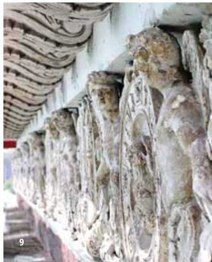
9. Фрагмент лепного декора фасада до реставрации
