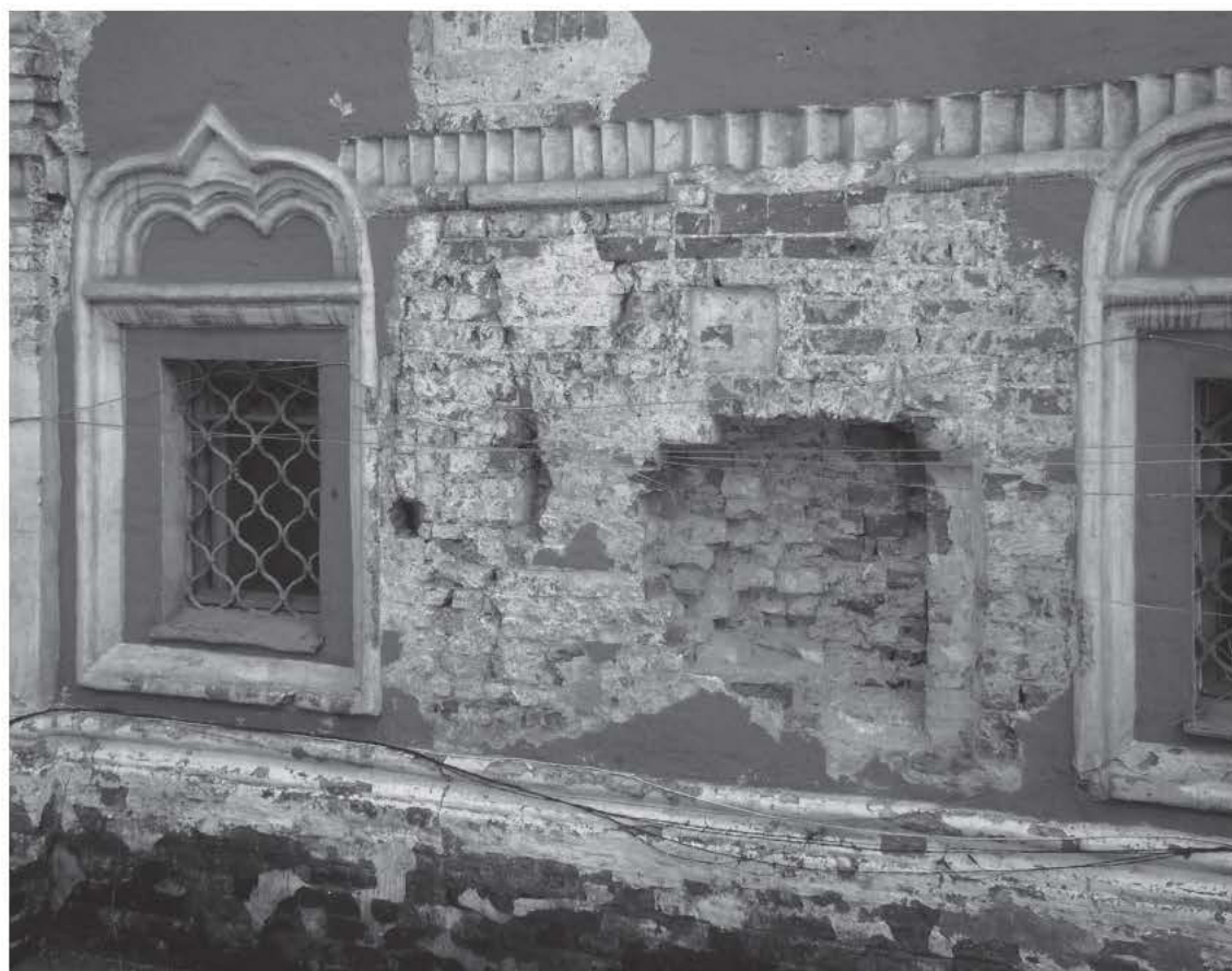
↑ Деформация стены здания, остатки простенка и цоколя
