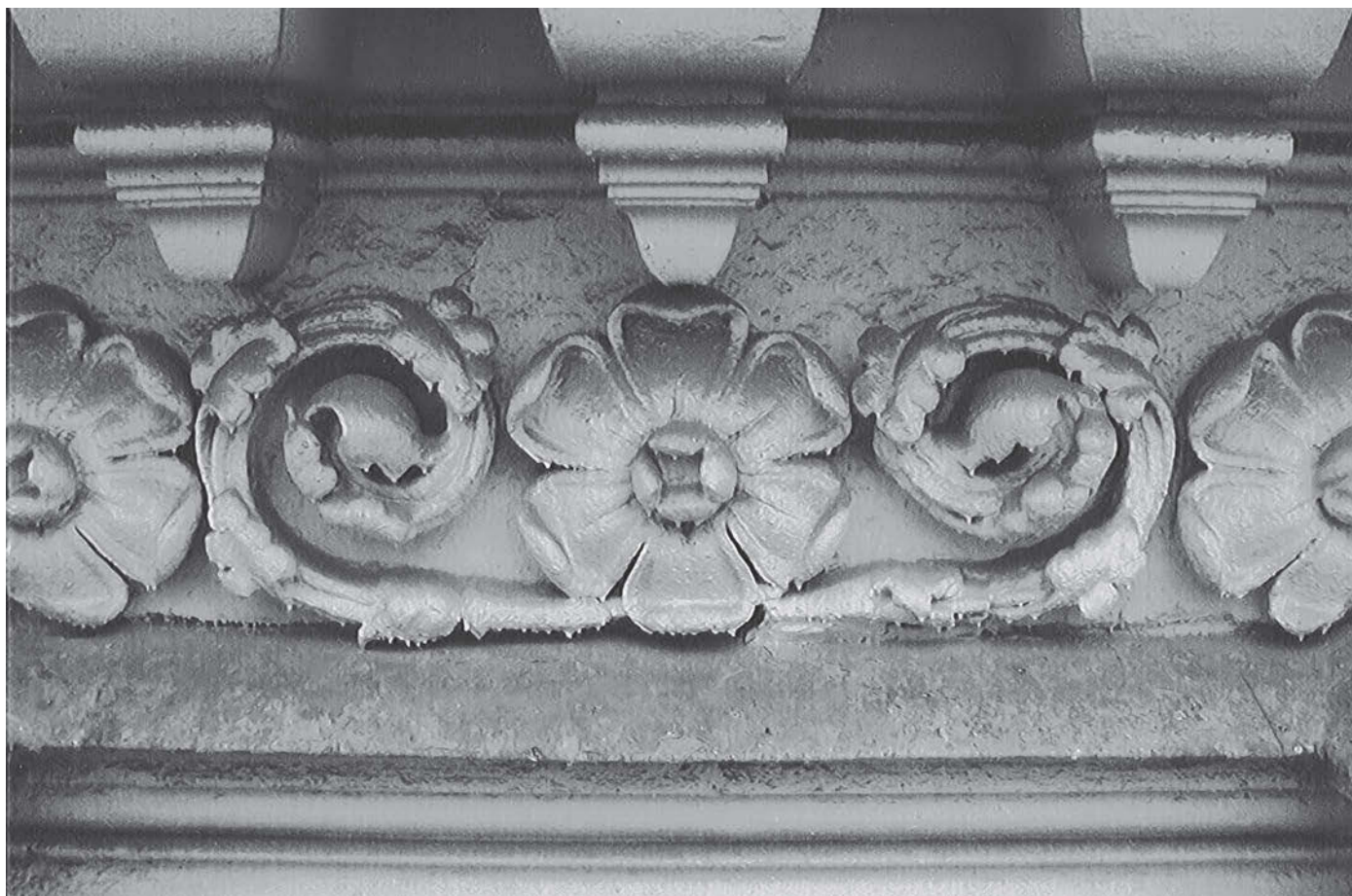
↑ Фрагмент лепнины фасада до реставрации
