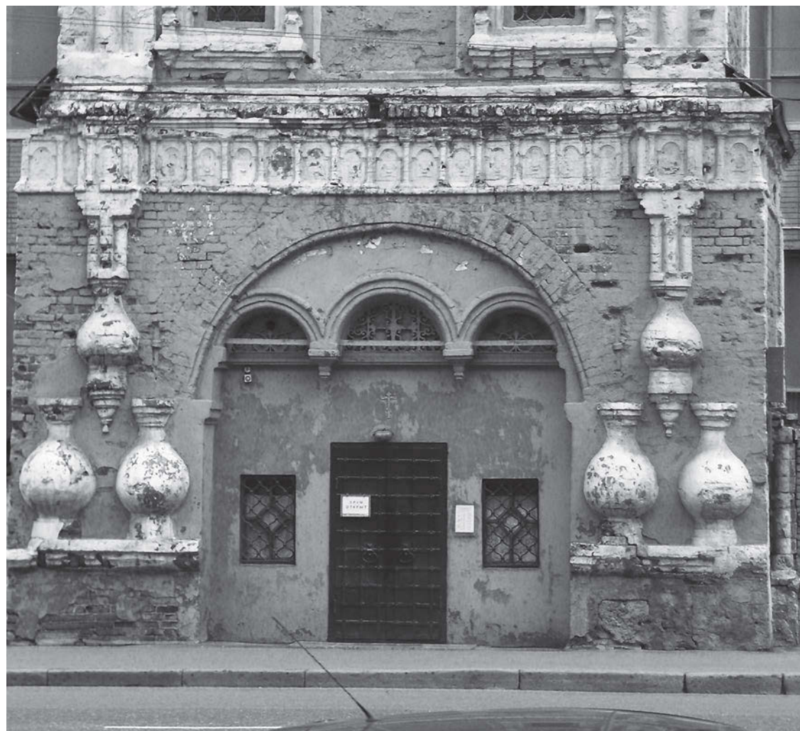
↑ Фрагмент главного фасада до реставрации: заложена проездная арка, под многочисленными слоями краски скрыты декоративные детали
