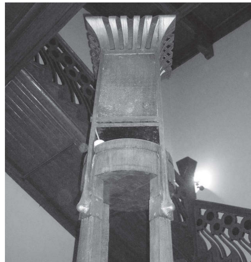
↑ Главная лестница до реставрации
