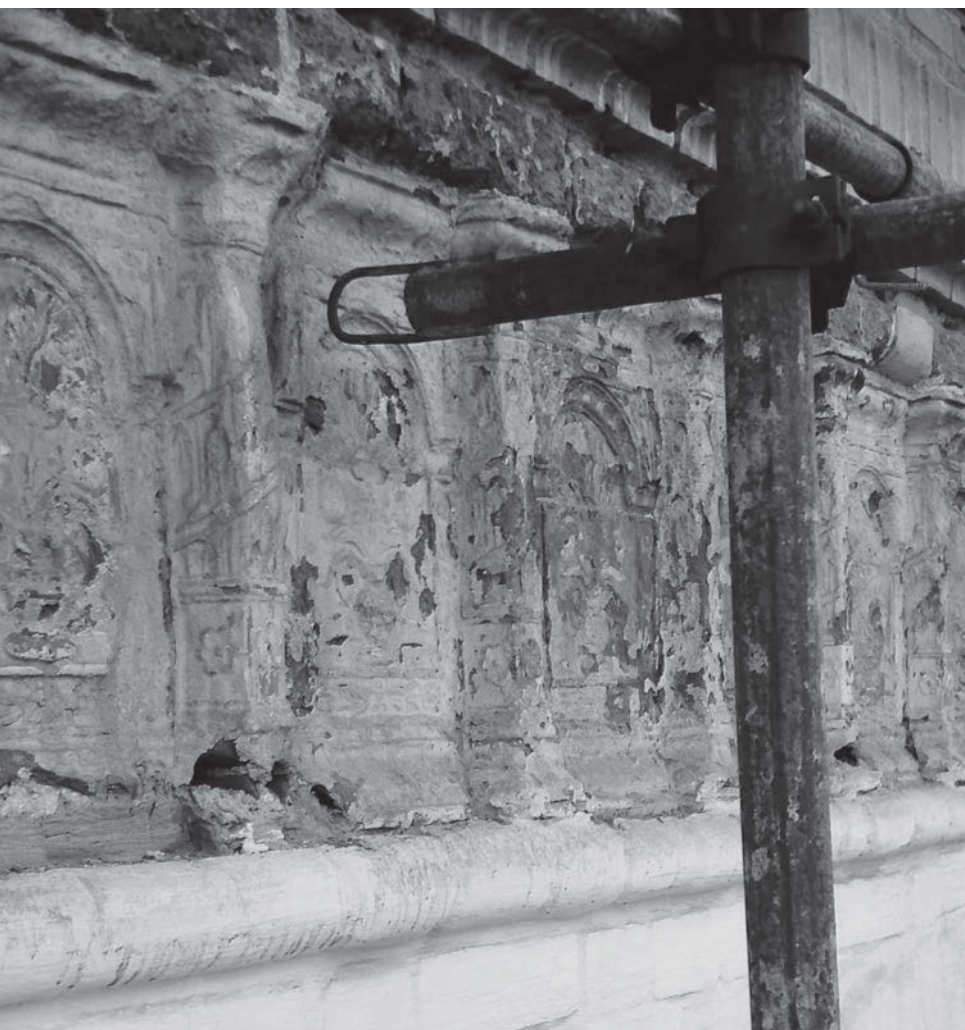
↑ Состояние изразцового фриза до реставрации
